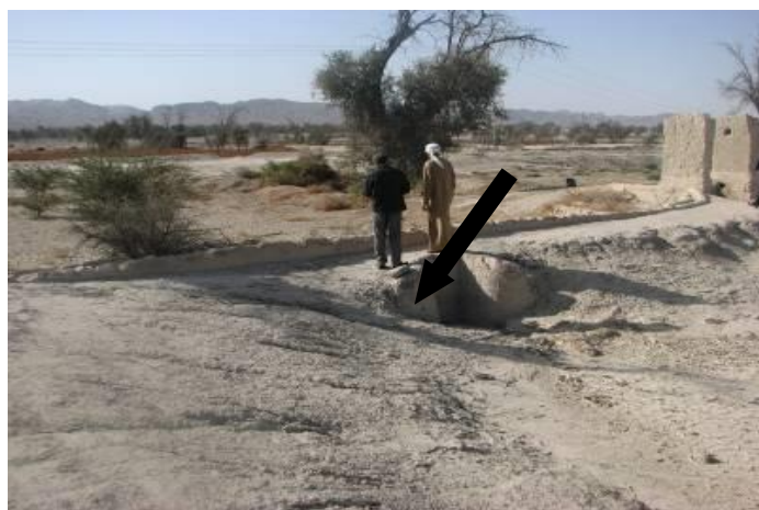
شکل (۴): دریچه کنترل بین تیربندها و چاه تغذیه‌ای مجاور آن بر روی پشته خاکی تیربند
