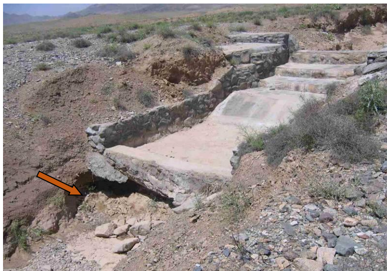
شکل ۱۰- پدیده آب‌شستگی پایین دست شیب‌شکن سامانه پخش سیلاب بر آبخوان کاشمر Figure 10- Scours phenomenon downstream of the drop of the FWSS on the Kashmar aquifer
