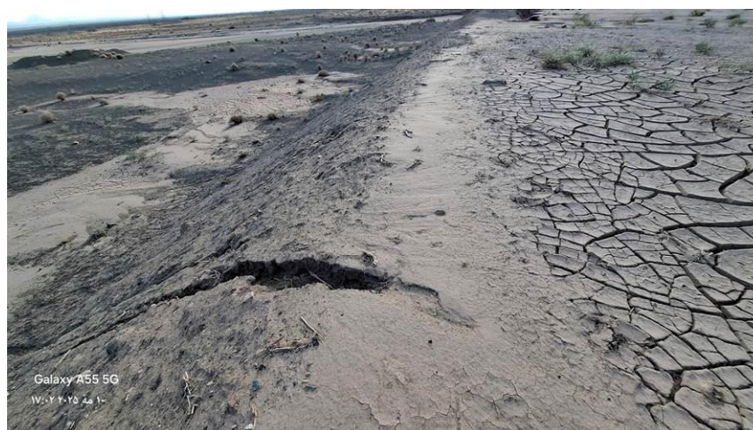
شکل ۹- رسوب‌گذاری زیاد در نهر آبرسان سامانه پخش سیلاب بر آبخوان سبزواری Figure 9- High Sedimentation in the main floodwater transfer channel of the FWSS on the Sabzevar aquifer
